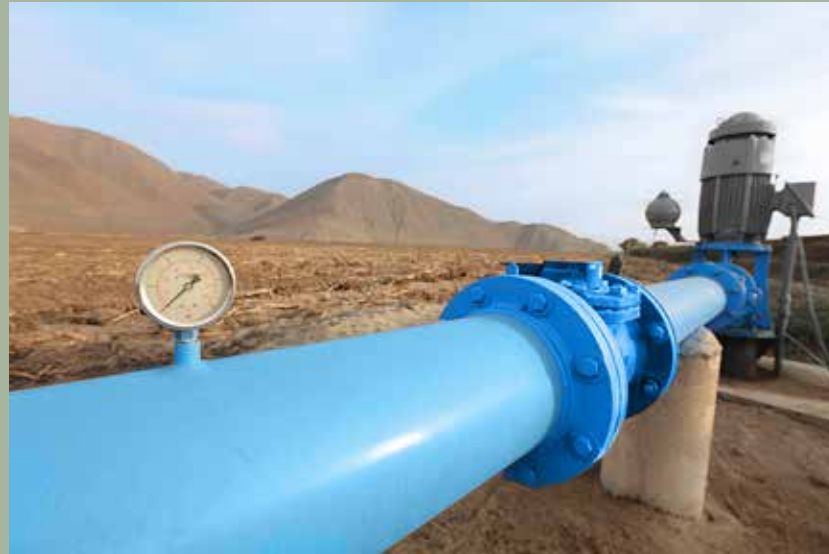
Línea de aducción Pozo Q6.
